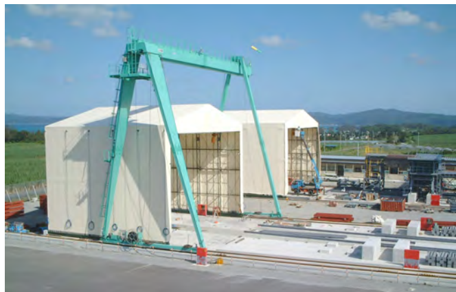
移動上屋、橋形クレーン
