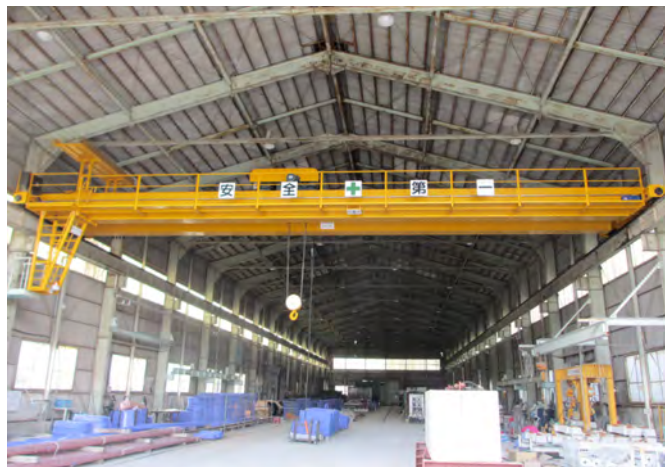
天井クレーン
