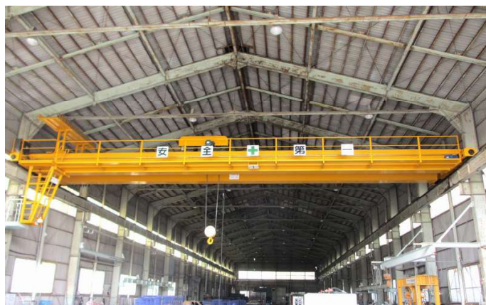
天井クレーン
